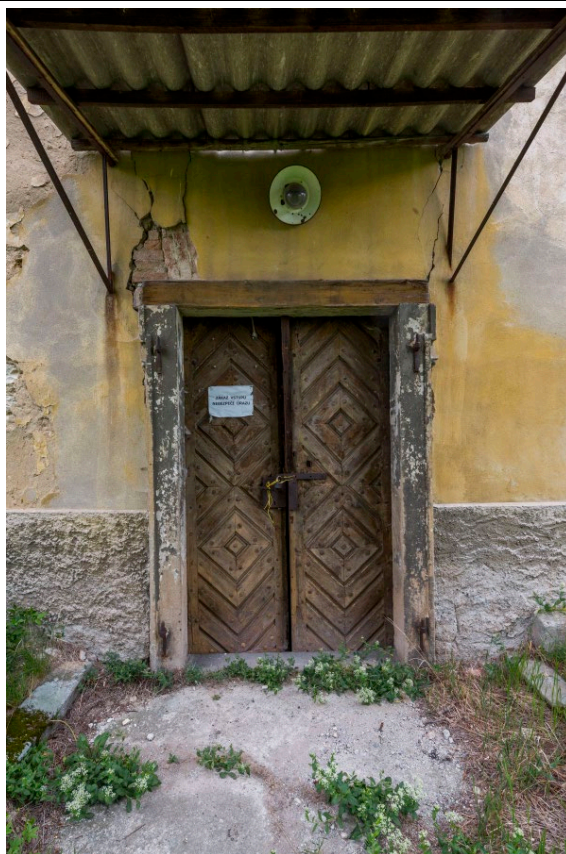
Detail portálu západního průčelí lodi v pohledu od západu. Foto: Marta Pavlíková 2019.
