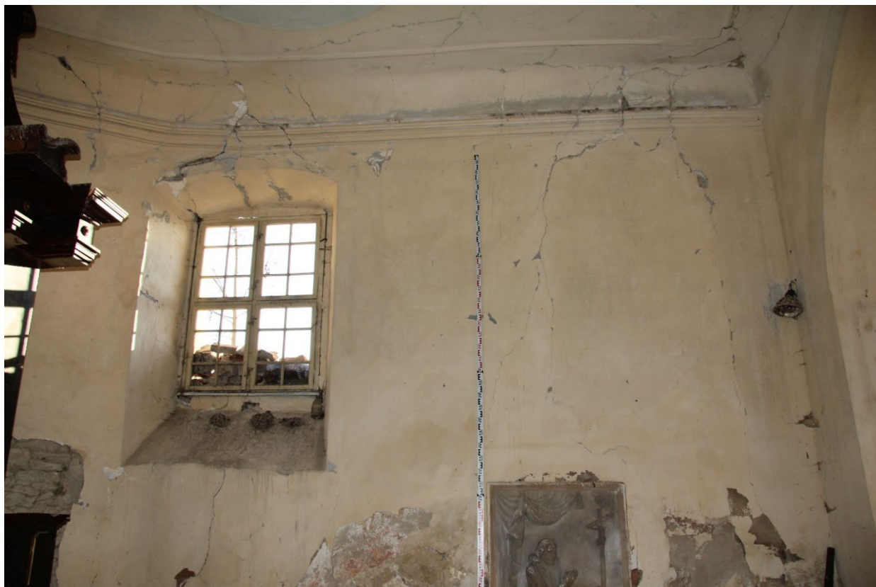
Jižní stěna presbytáře v pohledu od jihu. Vpravo jsou patrné praskliny v omítce indikující patrně okenní otvor. Foto: Marta Pavlíková 2019.
